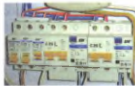
Рис. 91. Современный квартирный щиток с предохранителями
